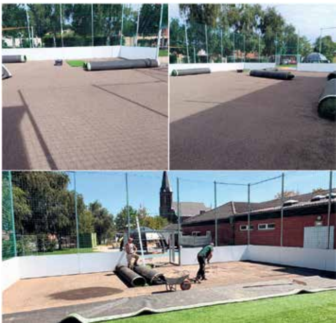
Gewährleistungsarbeiten am Kleinspielfeld Grundschule Eschweiler über Feld
